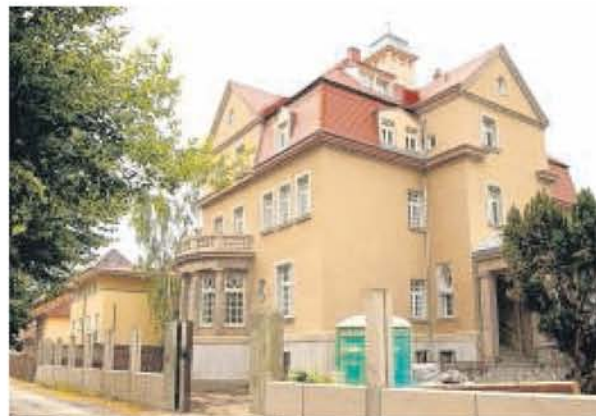
Sanierung voll im Gange: die 1912 erbaute Villa des Kaufmanns Hugo Reimann in der Windscheidstraße 38/40.
